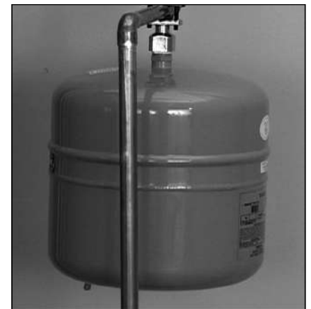
Figure 5 - Un réservoir de dilatation thermique aide à protéger le système de plomberie de votre domicile des pointes de pression.
