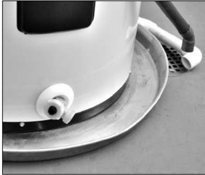
Figure 6 - Un bac de vidange approprié canalisé à un drain adéquat peut aider à protéger le plancher des fuites et des égouttements.
