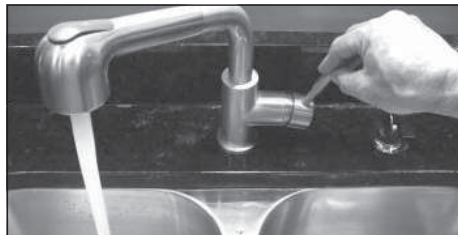
Figure 23 - Robinet à eau
