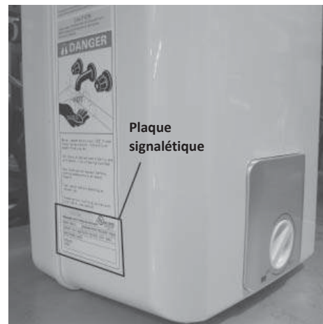
Figure 17 - Les exigences électriques du chauffe-eau peuvent être déterminées à partir de la plaque signalétique.
