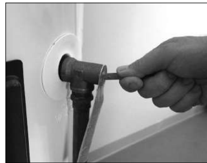
Figure 38 - Soupape de décharge DST
