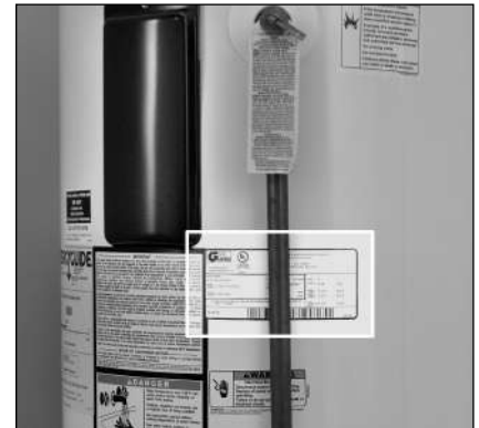
Figure 18 - Les exigences électriques du chauffe-eau peuvent être déterminées à partir de la plaque signalétique.
