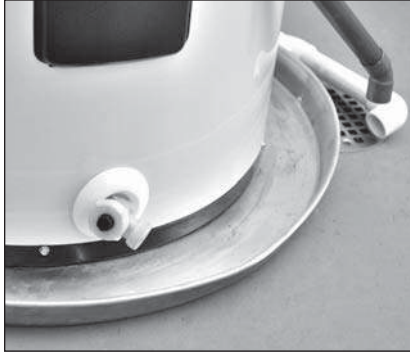
Figure 6 - Un bac collecteur adapté raccordé par un tuyau à un écoulement approprié peut permettre de protéger le plancher des fuites et égouttements.
