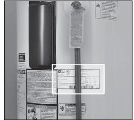
Figure 18 - Les exigences d'alimentation électrique du chauffe-eau figurent sur sa plaque signalétique.
